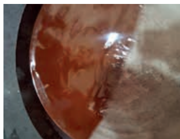
Korrosionsablagerungen in der Kühlflüssigkeit. Derartige Verunreinigungen erbringen den Nachweis dafür, dass das komplette Kühlsystem von Korrosion befallen ist.
